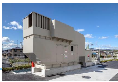
非常用発電設備
